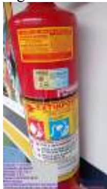
Figura 15 –Extintor de incêndio vencido.
