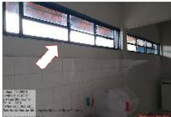
Figura 27– Janela da cozinha sem tela milimétrica.
