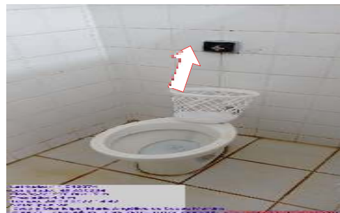
Figura 18 – Válvula de descarga danificada.
