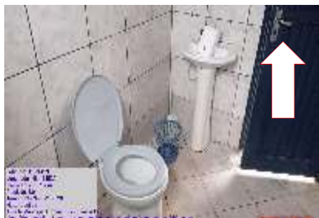
Figura 11 – Ausência de espelho e papeleira, dispenser de sabão desinstalado.
