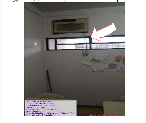
Figura 07 – Fiação elétrica exposta.
