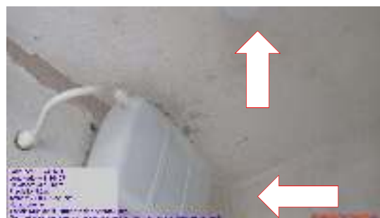
Figura 05 – Parede e laje com infiltração
