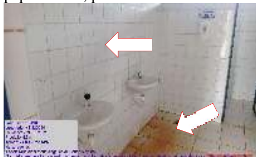
Figura 17 – Ausência de espelho e porta papel toalha, piso manchado.
