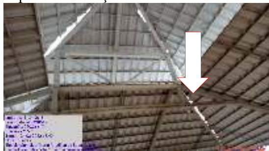
Figura 10 – Estrutura metálica do telhado exposta à oxidação
