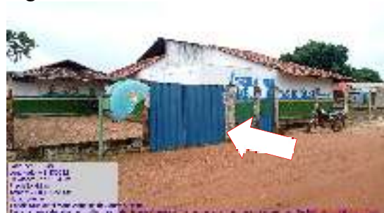
Figura 01 – Portão de acesso danificado
