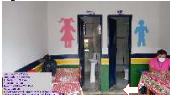
Figura 16 – Sanitários sem acessibilidade.
