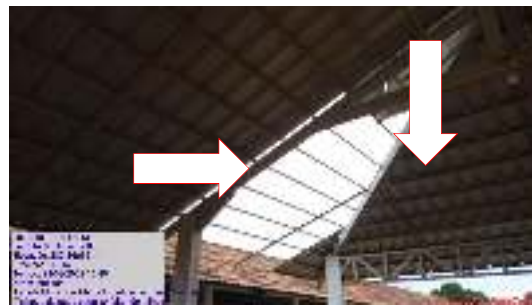
Figura 11 – Telhado com falta de telhas
