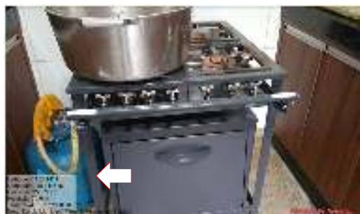
Figura 20 - Botijão acondicionado dentro da cozinha.
