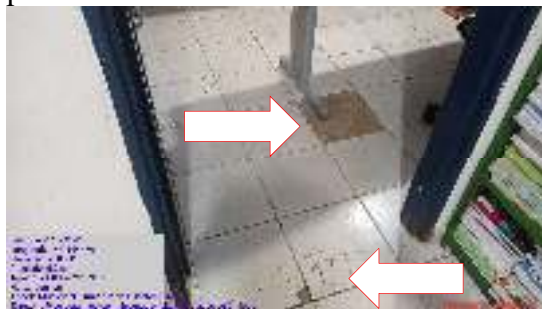
Figura 06 – Piso cerâmico quebrado e placas faltando.
