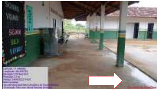
Figura 16 –Ponto com alagamentos.
