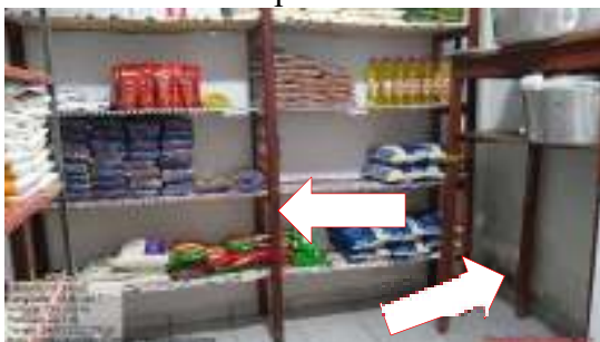
Figura 22 - Infiltração na parede, paredes sem acabamento e prateleiras de madeira.
