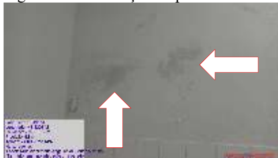
Figura 13 – Infiltração na parede.
