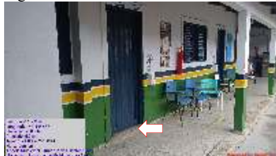
Figura 17 – Sala sem acessibilidade.
